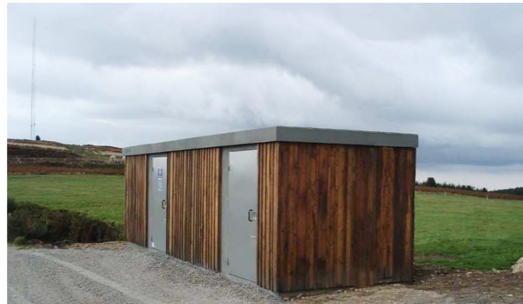
Exemple de poste de livraison habillé d'un bardage bois (parc éolien de Margnes / Tarn)
